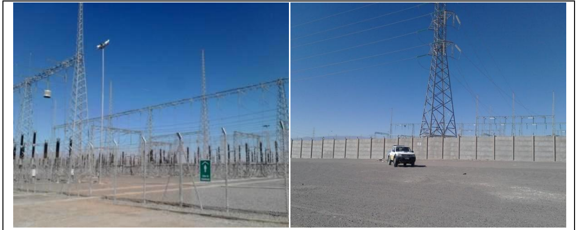
Figura 15: Subestación Lagunas y Subestación Crucero. Fuente: Elaboración propia.
